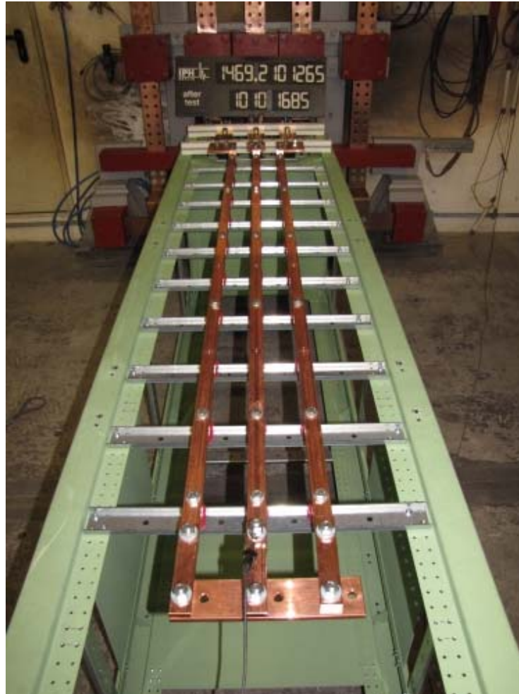
Foto 8: 30 mm x 10 mm-Sammelschienensystem, Stützabstand 400 mm nach der Stoßstromprüfung
