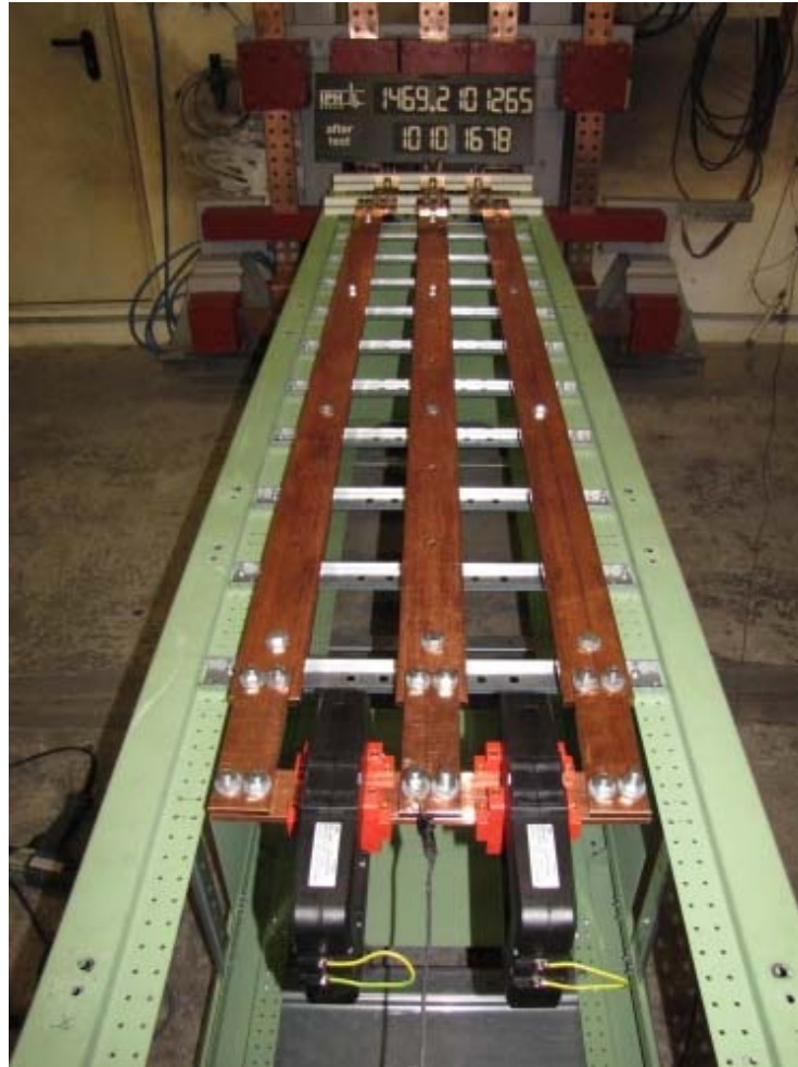
Foto 5: 80 mm x 10 mm-Sammelschienensystem, Stützabstand 400 mm nach der Stoßstromprüfung
